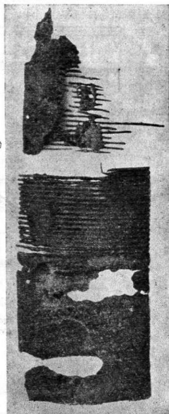
128. zīm. Gruntsūdens bojāta dzelzs akas caurule.
