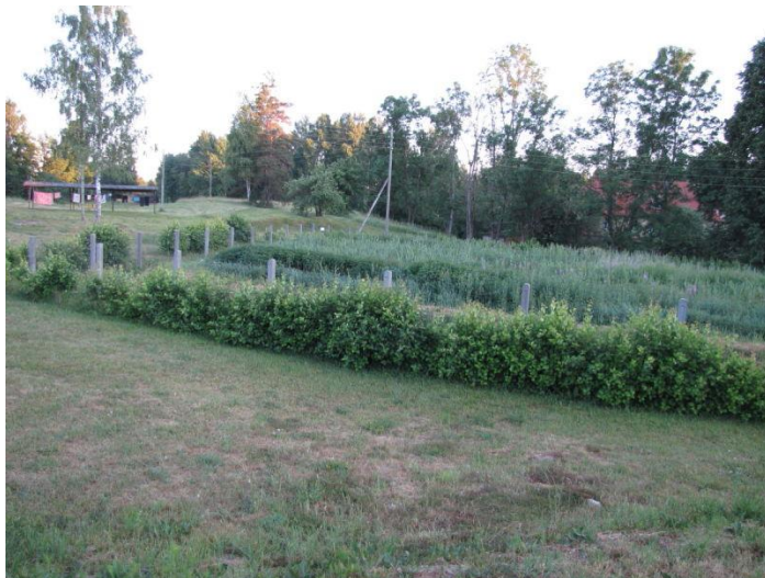
9.8.5. att. Bioloģiskā ūdens attīrīšanas iekārta Jēkabpils novada Vidsalas ciematā (izveidota 2006. g.)
