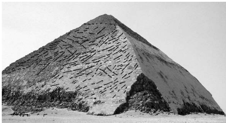
1. attēls. Lauztās piramīdas rietumu fasādē noteiktās plaisas.
