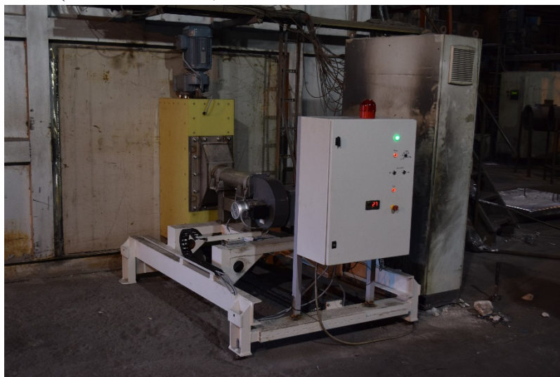
4.24. att. Izveidotā industriālā mēroga viena dipola iekārta, uzstādīta uz 22 t alumīnija krāsns
