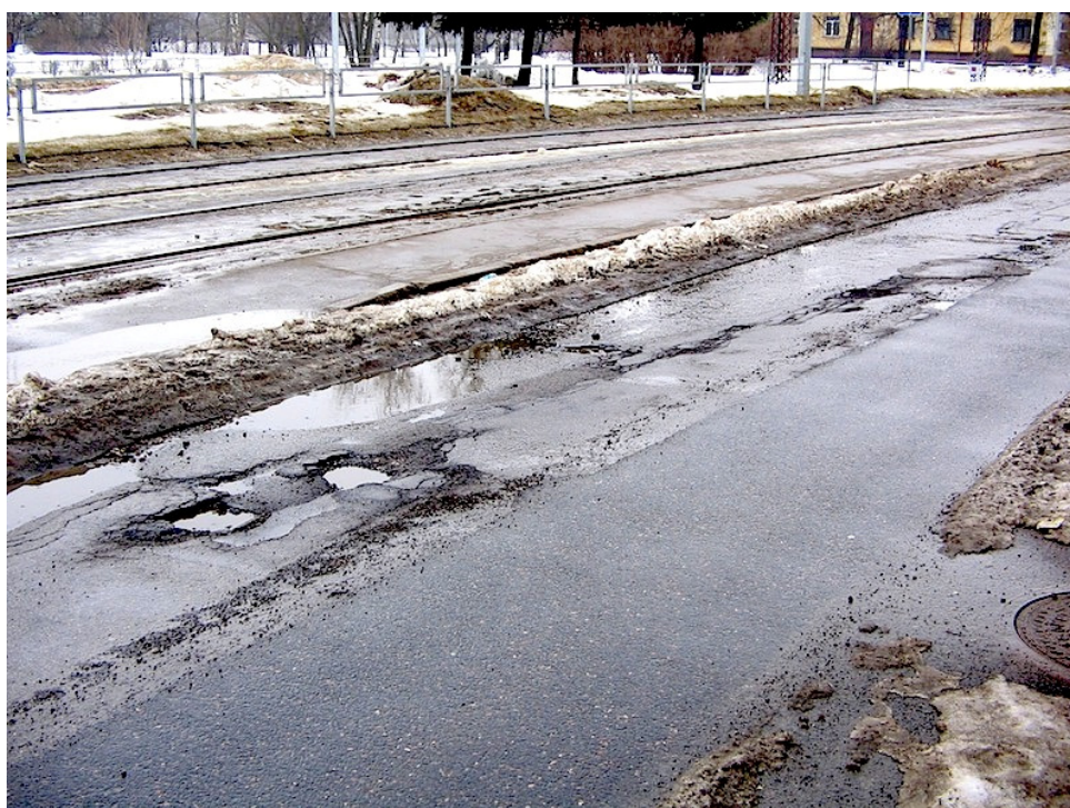
4.3. att. Pirmais testētais ceļa seguma fragments ar vizuāli pamanāmu bojājumu
