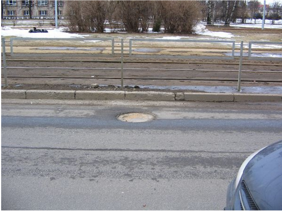
P2.5. att. Ceļa bojājumu klases kanalizācijas akas vāks paraugs. Laiks 24.03.2011 14:41, koordinātes N 56:58.730 E 024:10.559
