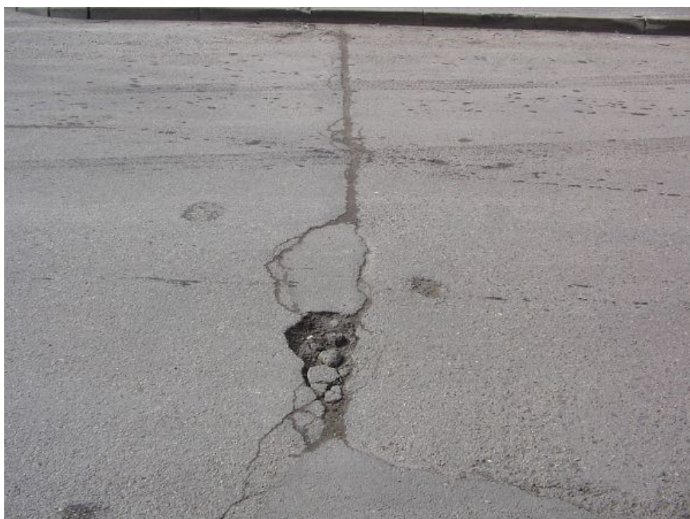
P2.2. att. Ceļa bojājumu klases maza bedre paraugs. Laiks 24.03.2011 14:20, koordinātes N 56:58.902 E 024:11.525
