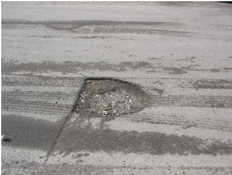
P2.1. att. Ceļa bojājumu klases liela bedre paraugs. Laiks 24.03.2011 14:20, koordinātes N 56:58.900 E 024:11.529
