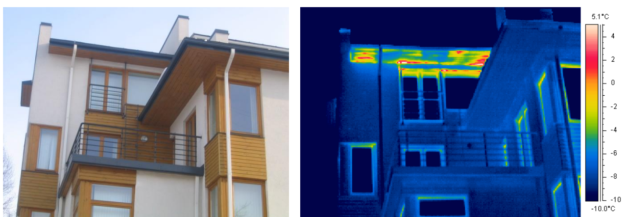
Attēls 2.23. Siltā gaisa izplūde pa neblīvējumiem būvkonstrukciju salaiduma vietās pie pārspiediena telpās.
