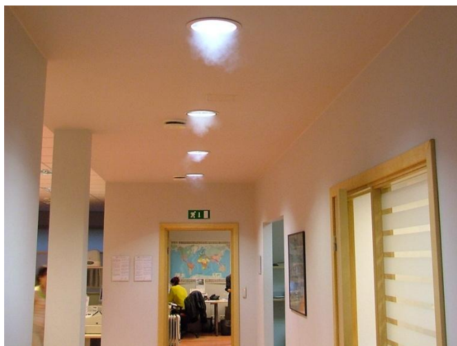
Attēls 2.107. Dūmi no testējamās telpas nonāk blakus telpas griestos un norāda uz to savienojumu.
