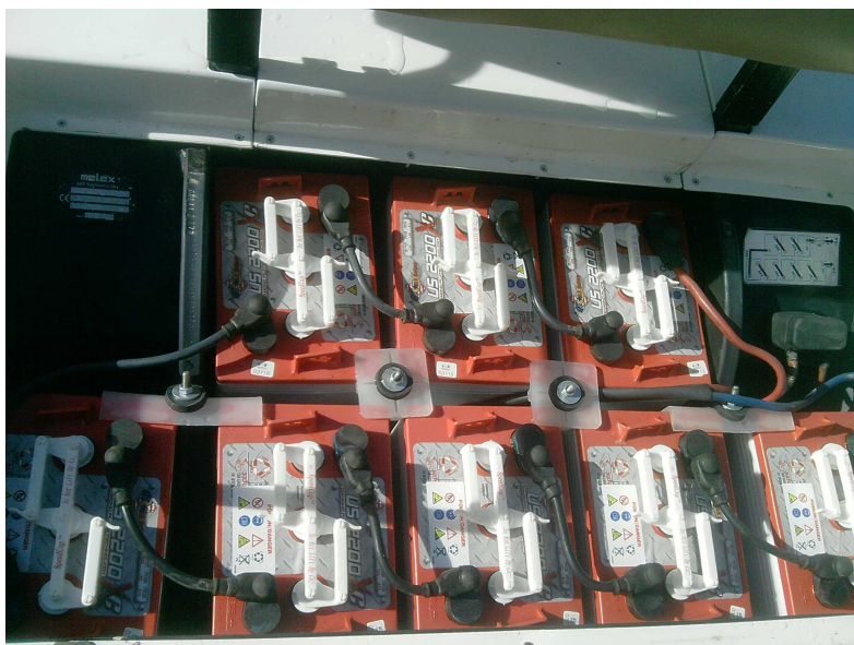
1.2. att. Akumulatoru baterijas
