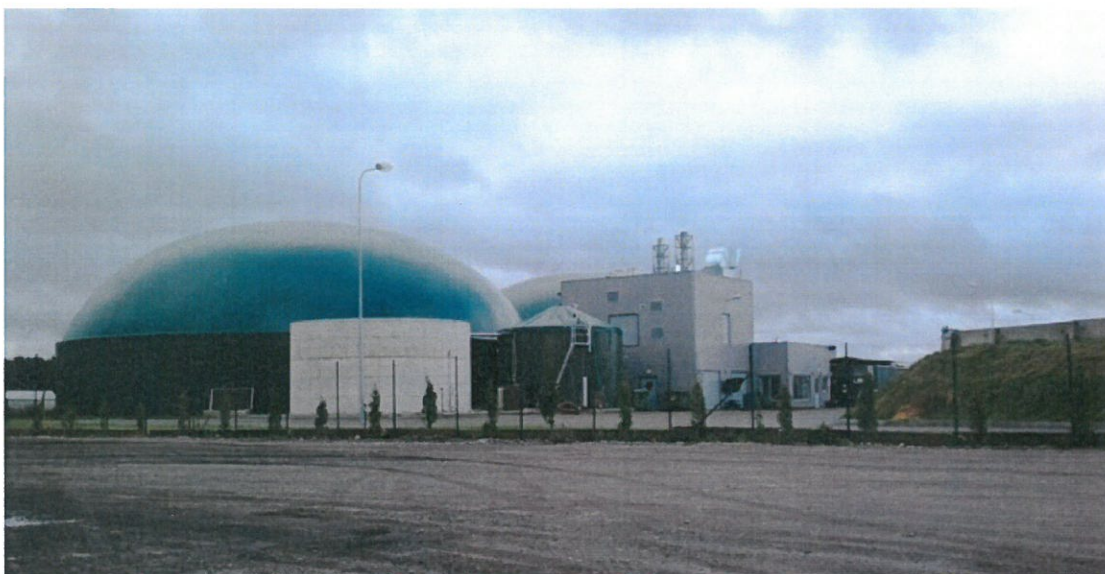
3.15att. Biogāzes ražotne SIA „Zaļā Mārupe”[20]
