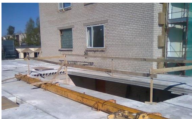
1.11. att. Nedroši uzstādīts nožogojums būvobjektā Jelgavā (autores foto)
