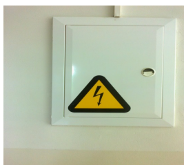
1.2.5.att., Elektrosadales skapis
