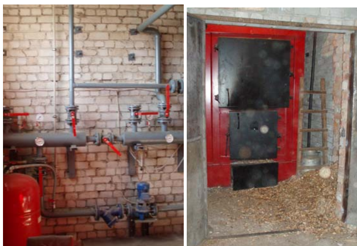
7.6.att. Apkures katls
