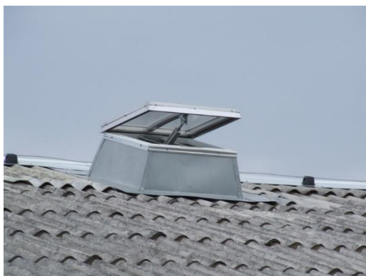
3.6.att. Ugunsdrošības automātiskā dūmu izvades lūka jumtā [attēls no autora personīgā arhīva]
