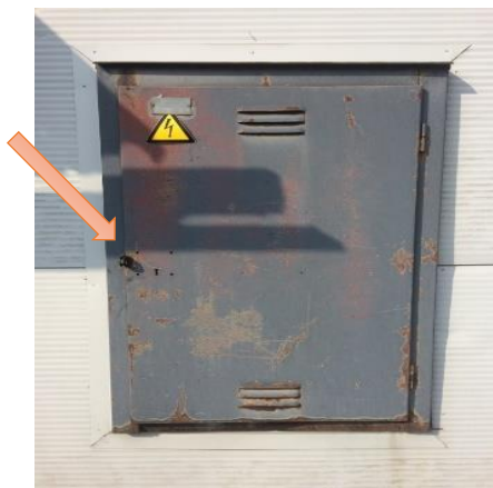
4.2. att. Elektrības sadales skapja durvis nav aizslēgtas [attēls no autora personīgā arhīva]
