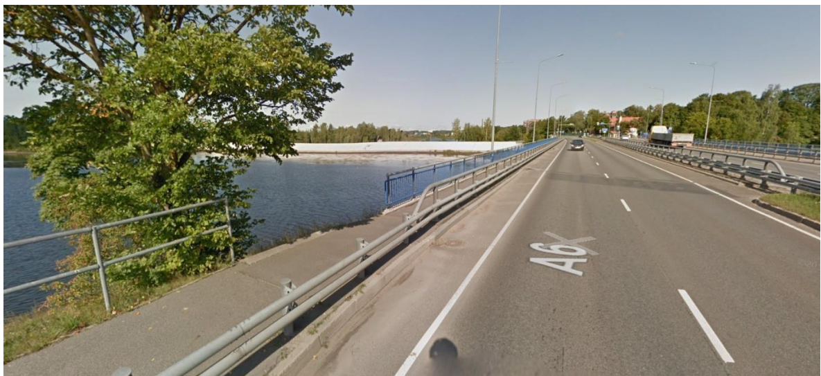
5.28. attēls. Bīstams norobežojumu trūkums pār tiltam Ogres upi (Google Street view).
