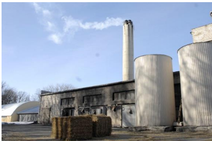
1.2.1. att Saulaines katlu māja 7
