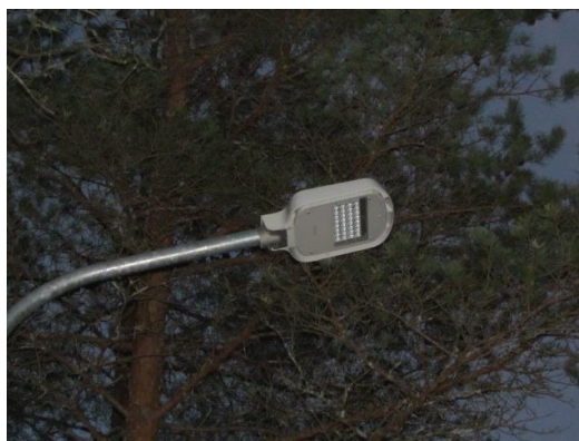
3.1.1.attēls. Apgaismojumā ķermenis Ogres Zilajos kalnos (autores foto)
