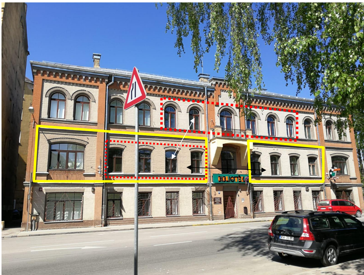
4.7. att. Nesakritības bibliotēkas fasādē: dažādi logu rāmju toņi, nesaskaņots apmetuma krāsojums
