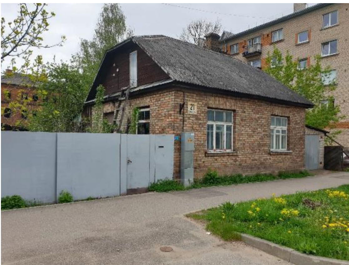
47.attēls. Pamesta ēka Strādnieku ielā 21
