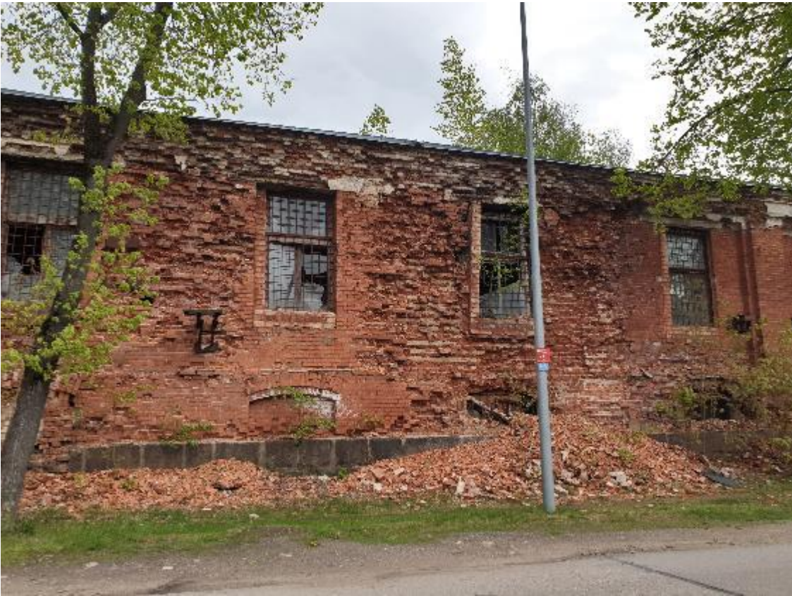
89.attēls. Degradēta ēka, Andreja ielā 98B
