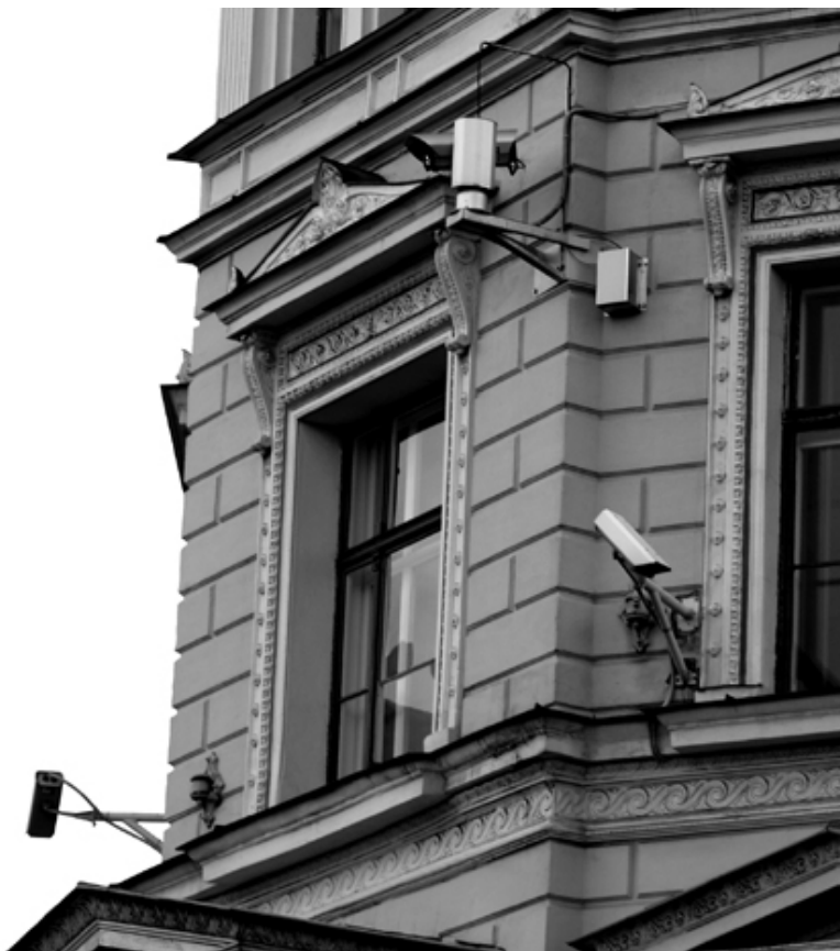
3.4 attēls. Video novērošanas centra kamera (augšā pa vidu) un lokālas privātās kameras Brīvības un Raiņa bulvāru krustojumā vietās.
